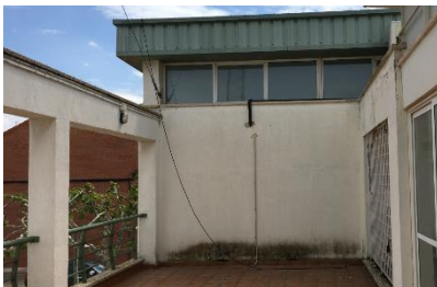
Manchas de humedad en fachada interior en terrazas y patios, edificio de servicios.
